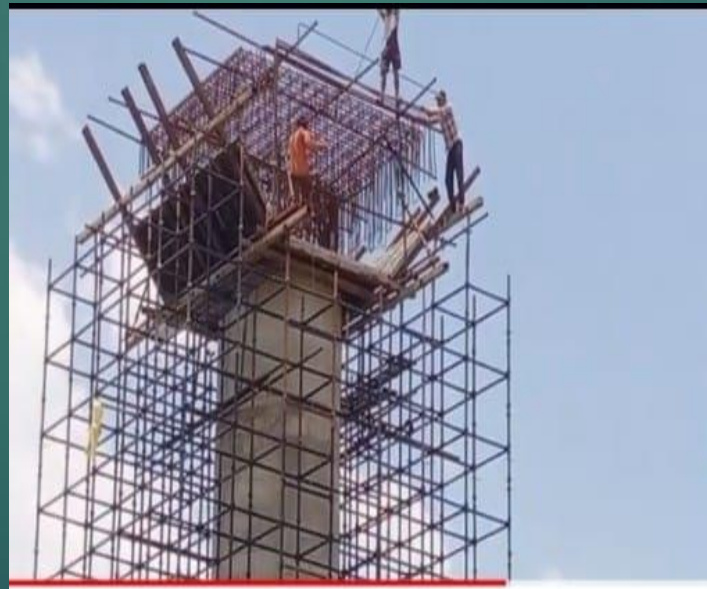
कौशांबी यमुना नदी New Bridge निर्माण कार्य I Kaushambi Bridge Uttar Pradesh I Yam...
